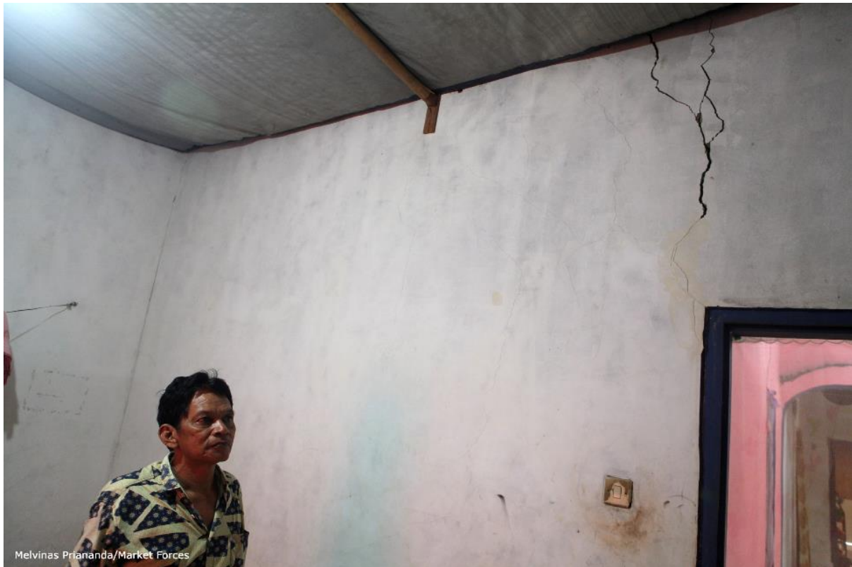
Kerusakan rumah akibat peledakan yang terjadi pada tahun 2017 di awal konstruksi Jawa 9 dan 10 (2021).
